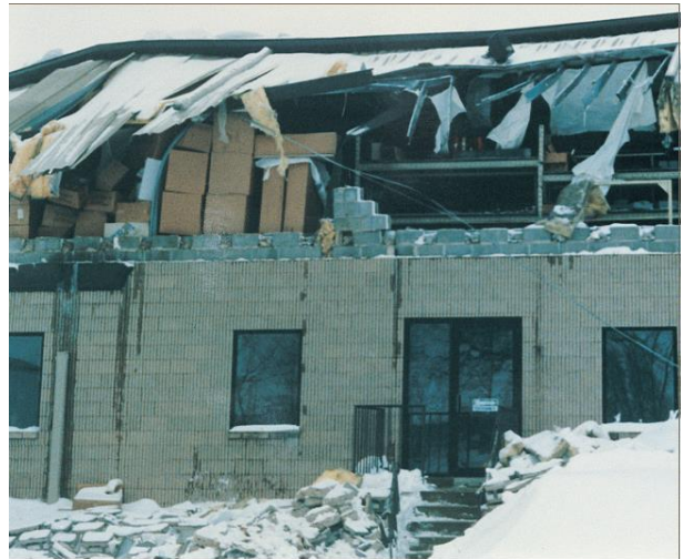
Téli viharban megrongálódott tetőszerkezet [9]
